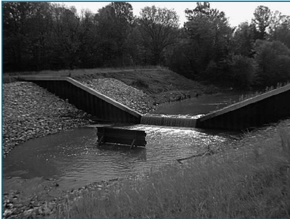
Structure de contrôle (“low-drop grade-control structure”) typique sur le Hotophia Creek, Mississippi.
